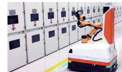
高電圧配電盤の操作
